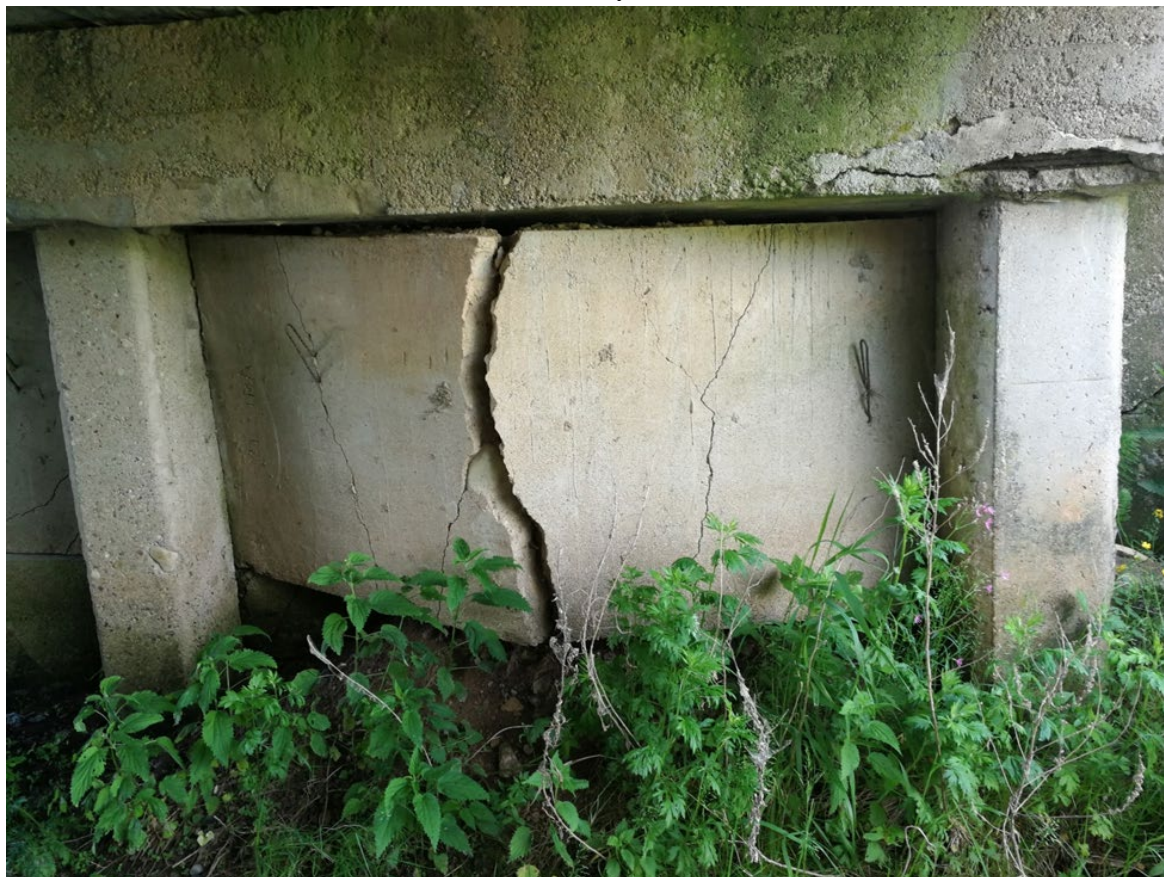
3 pav. Trūkusi betono palaikomoji konstrukcija
